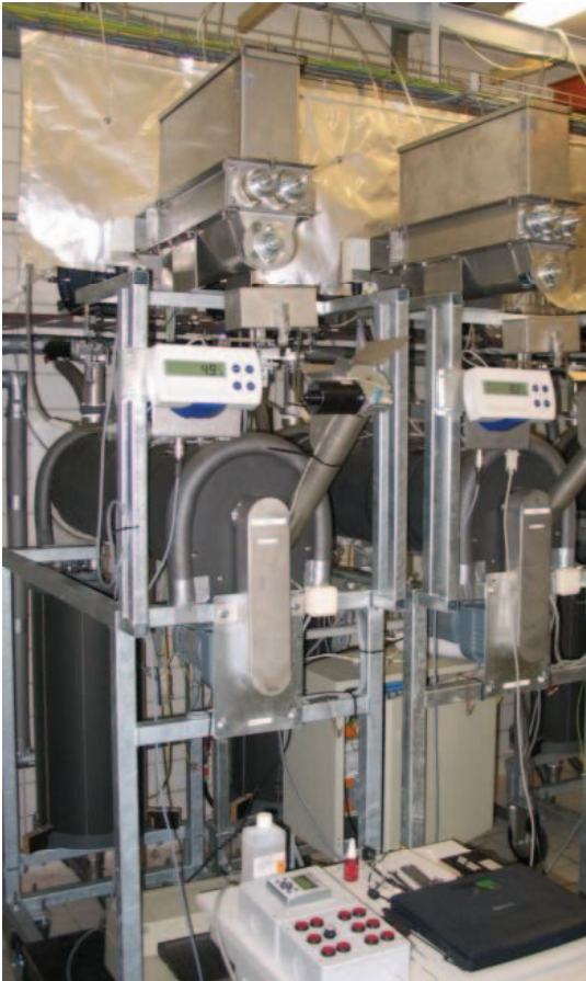
Befüllautomaten für den kontinuierlichen automatischen Betrieb von Biogas-Laborfermentern
